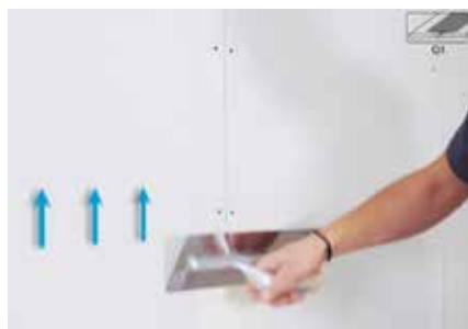
01 | Vyplnenie škáry tmelom Škára medzi sadrokartónovými doskami sa vyplní práškovým alebo pastóznym tmelom. Tmel sa nanesie hladidlom.
